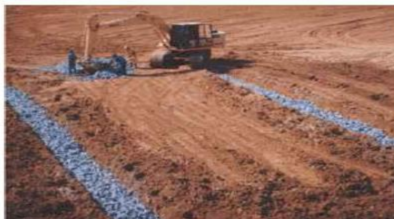
Figura 11 - Drenos de chorume preenchidos com brita
