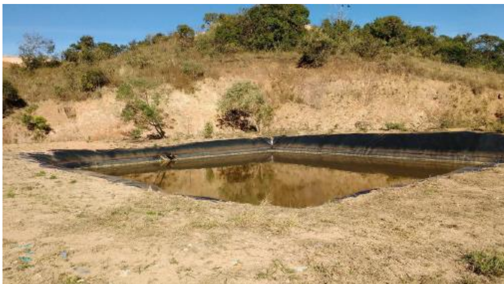
Figura 09: Lagoa anaeróbia do Aterro Sanitário de Andradas. Data: jun/2016.
